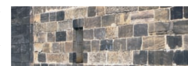
Bild oben: Stark sanierungsbedürftiges Gebäude in der Ludwigstraße
